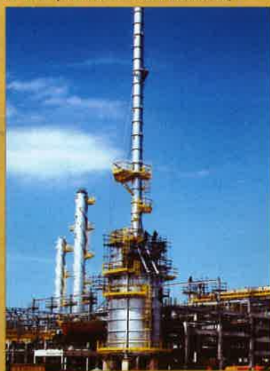
Fig. 37. Forno Petroquímico da Combustol (Cabiúnas)
